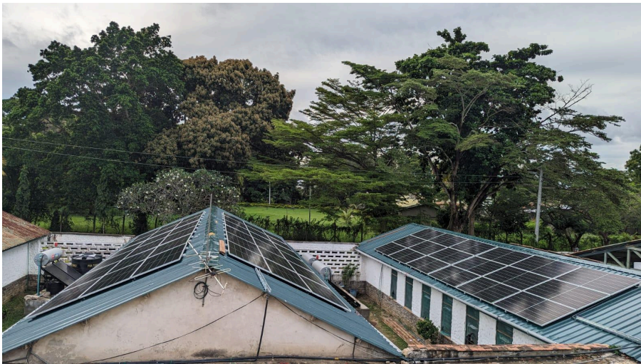
De nieuwe zonnepanelen voor de APDK kliniek Mombasa
